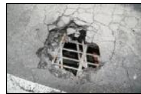
図1. 床版の抜け落ち
